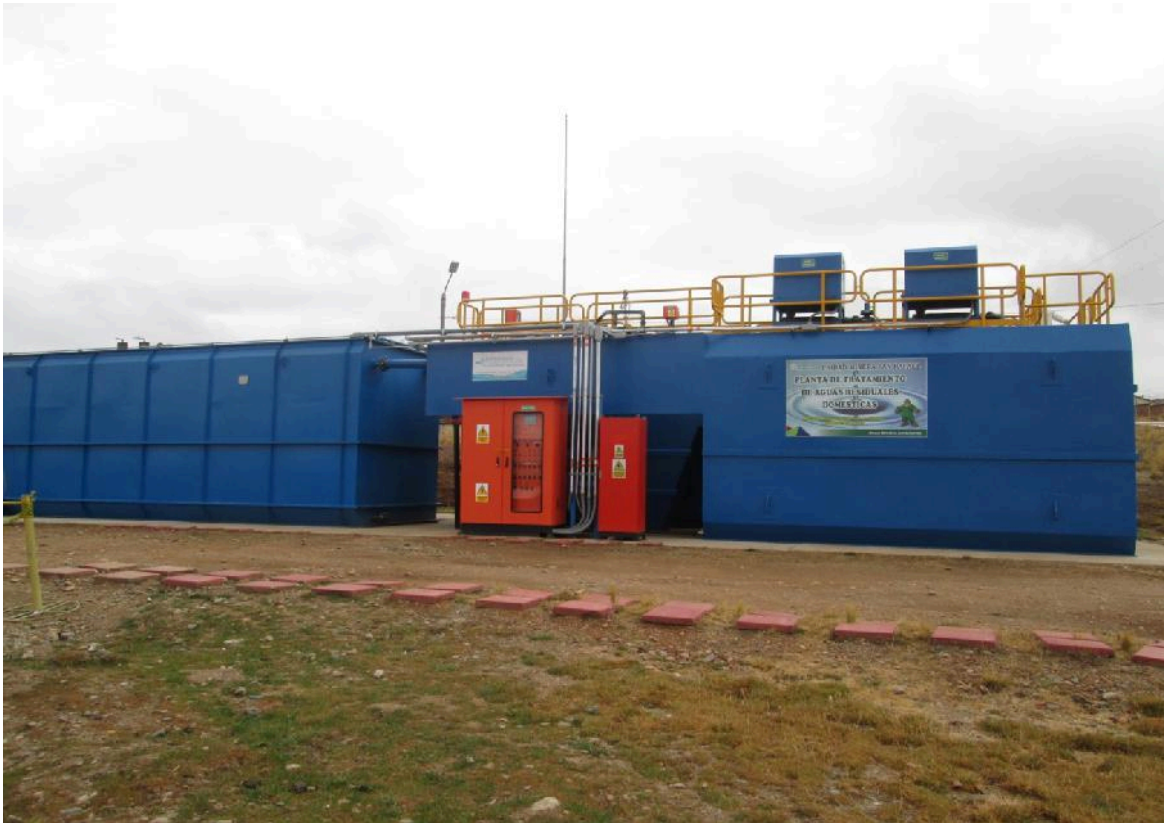
Figura 11: Planta de tratamiento de aguas residuales domésticas San Rafael 2023.
