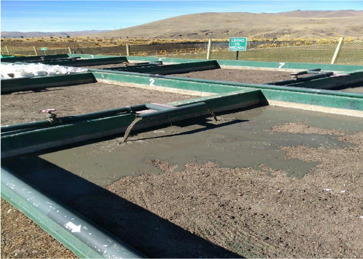
Figura 13: Lecho de secado donde se evacua el exceso de lodo formado en los reactores.
