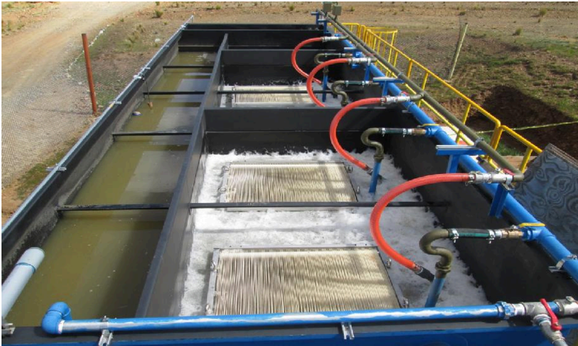
Figura 12: Cámara de biorreactores de membrana
