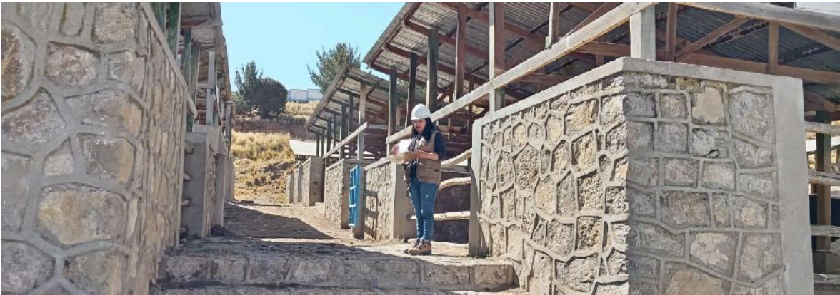
Figura 16: Evaluación para el mapa de riesgos del camal las instalaciones en general del camal municipal.
