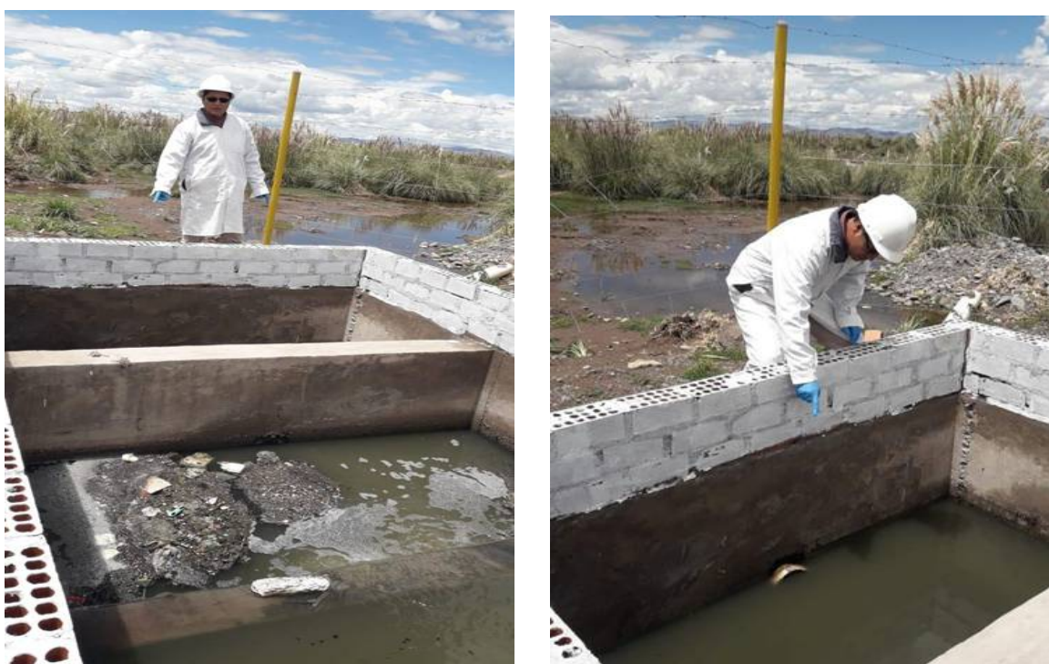
Figura. 04. TUBO DE SALIDA DEL DESARENADOR HACIA AL RÍO
