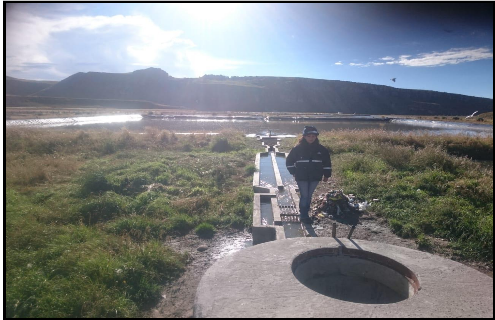
Figura 23: Afluente punto de inicio donde se vierte agua cruda al buzón de la PTAR.
