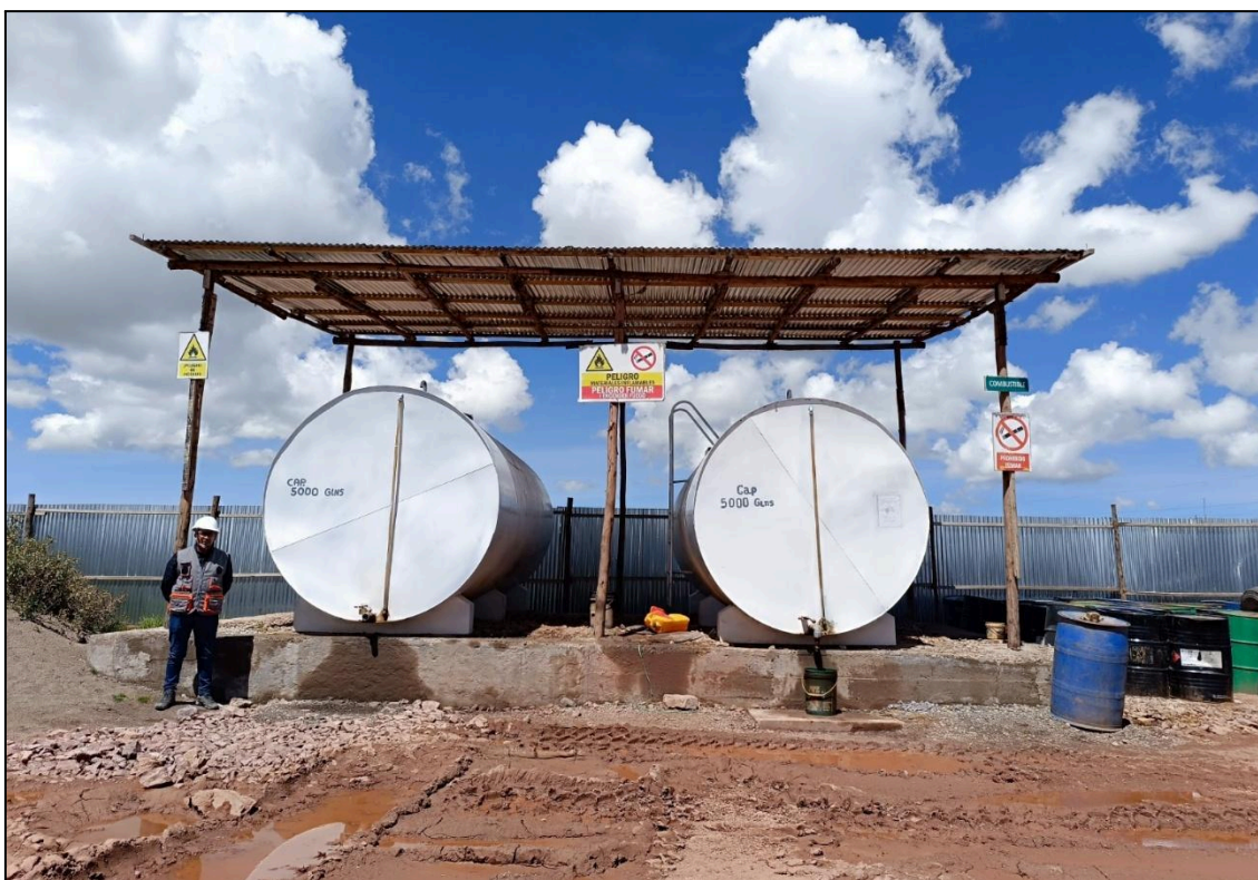
Figura 20: Disposición de señalización.
