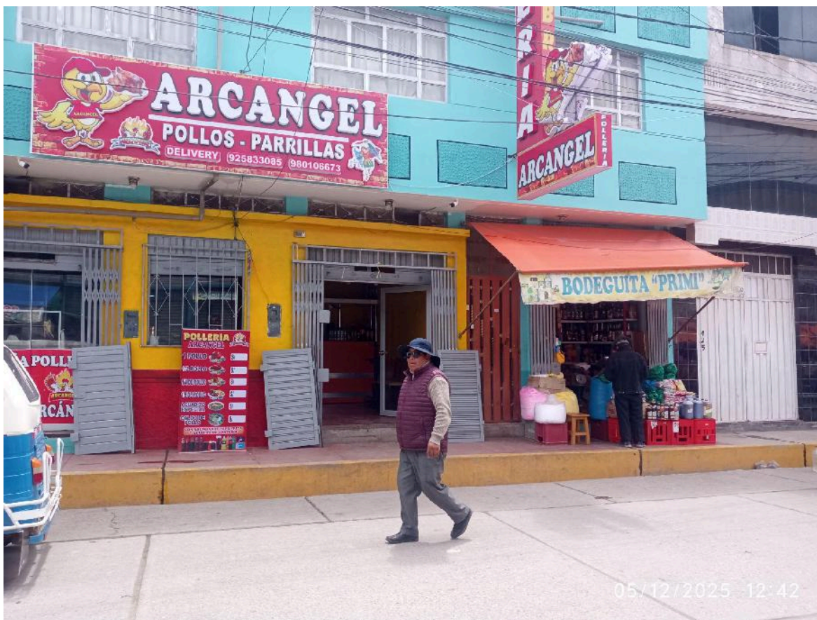
Figura 37: En la siguiente imagen se aprecia letreros publicitarios que están elevados pero algo a tener en cuenta es que invade la vereda y sobre sale a la calle, por otra parte también se observa los cables colgantes mal organizados. ( JR.CHUCUITO 05/12/2025 )
