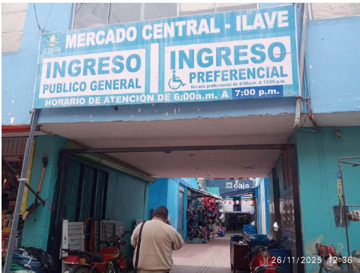
Figura 26: En esta imagen se ve como está deteriorado el letrero del mercado central y debería ser cambiado para un mejor aspecto.( JR. NICOLAS DE PIEROLA 26/11/2025 )
