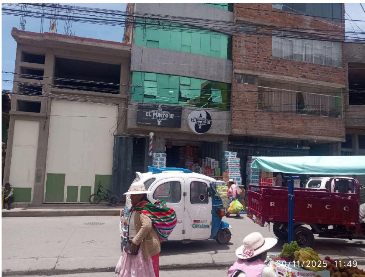
Figura 31: En el jr Atahualpa con cruce con el Jr Chucuito se observa la cantidad de cables que pasan de un lado a otro y que necesitan un reordenamiento. ( JR. ATAHUALPA 30/11/2025 )
