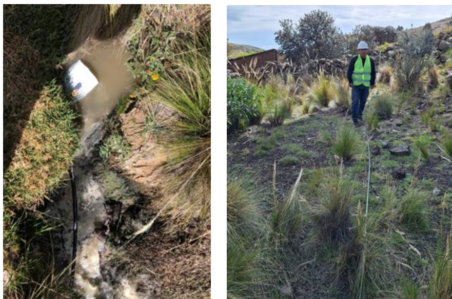
Figura 07: Línea de conducción de efluente
