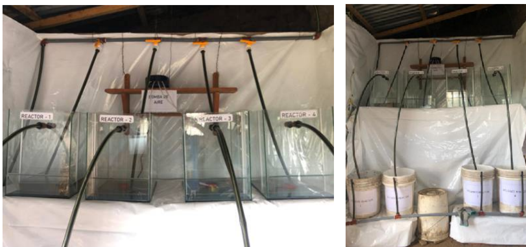
Figura 06: Sistema de tratamiento instalado
