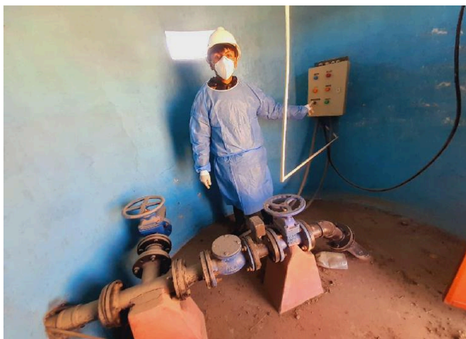
Figura 20: Caseta de captación (PM1) del sistema de distribución de agua potable del Centro Poblado De Challapujio Suyo.
