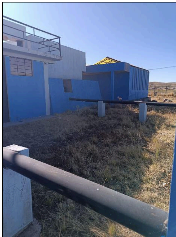
Figura 10. Vista panorámica de la PTAR.
