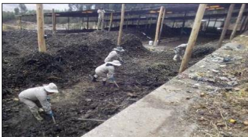
Figura 09: Falta de maquinarias.
