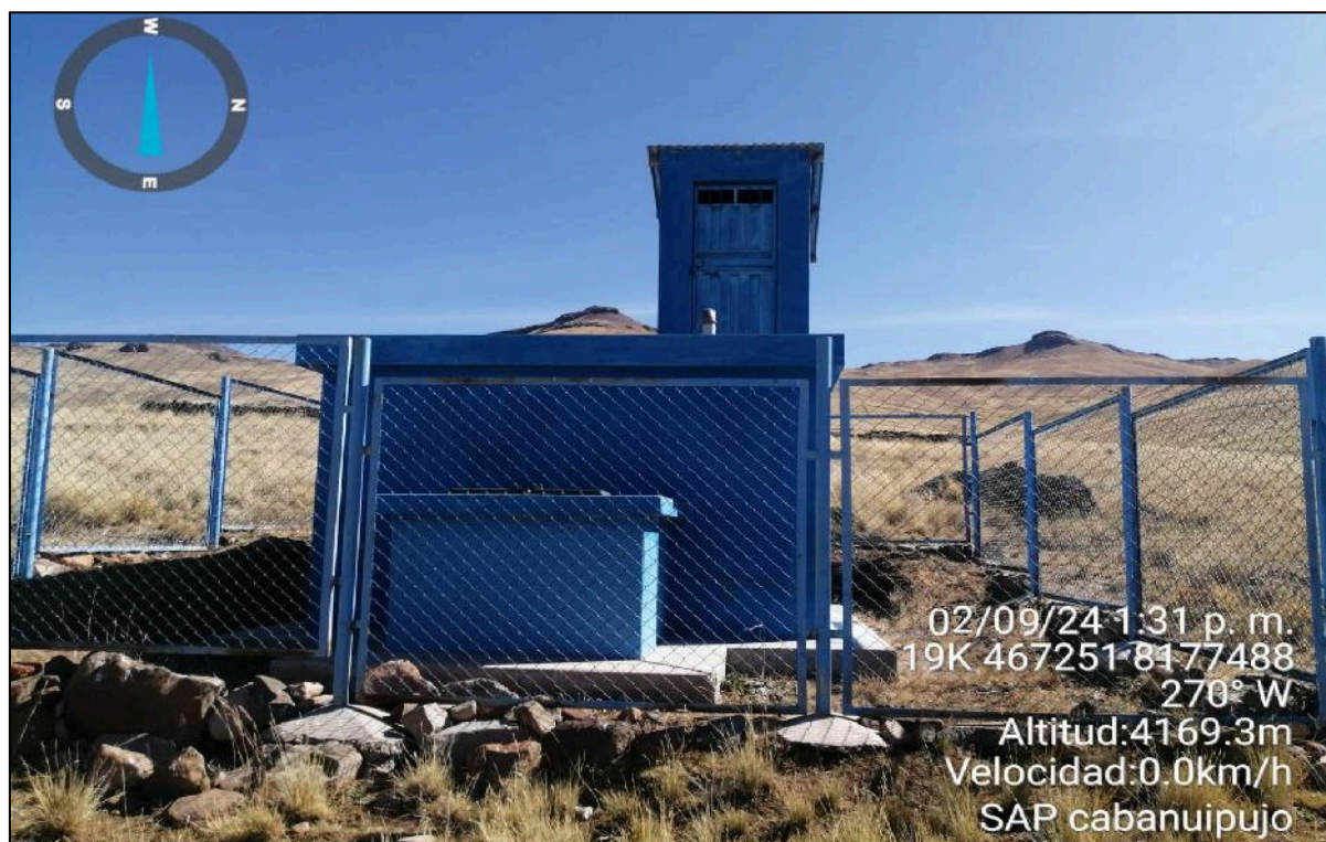
Figura 22: Sistema de abastecimiento de agua (reservorio) del centro poblado de Cabanuipujo.
