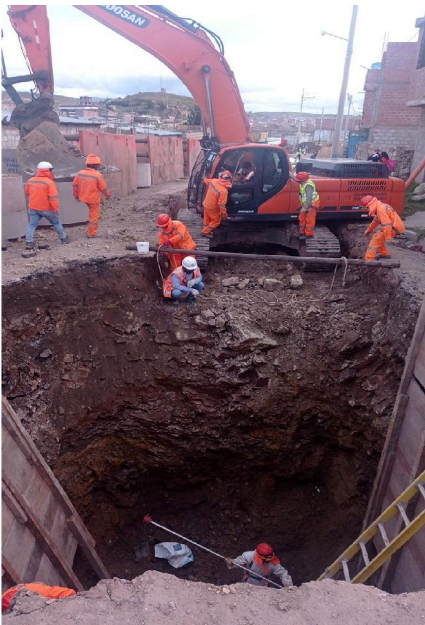
Figura 86: Magnitud de las excavaciones, lo que ocasiona grandes cantidades de material para almacenar en lugares cercanos o buscar su disposición final, ocasionando pérdida de la calidad del suelo y cambios en el relieve.
