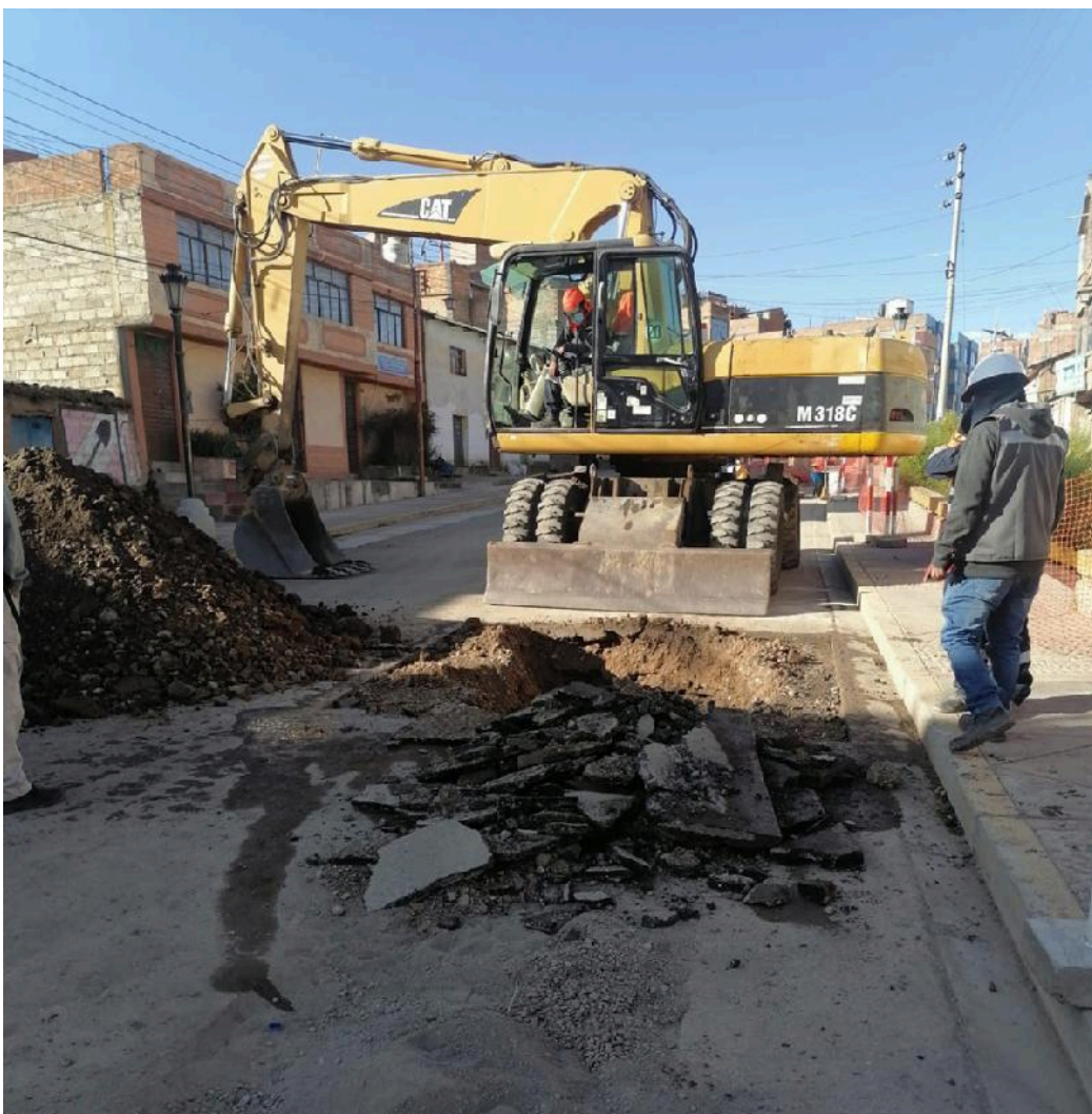
Figura 93: Generación de residuos de la construcción peligrosos asfalto flexible
