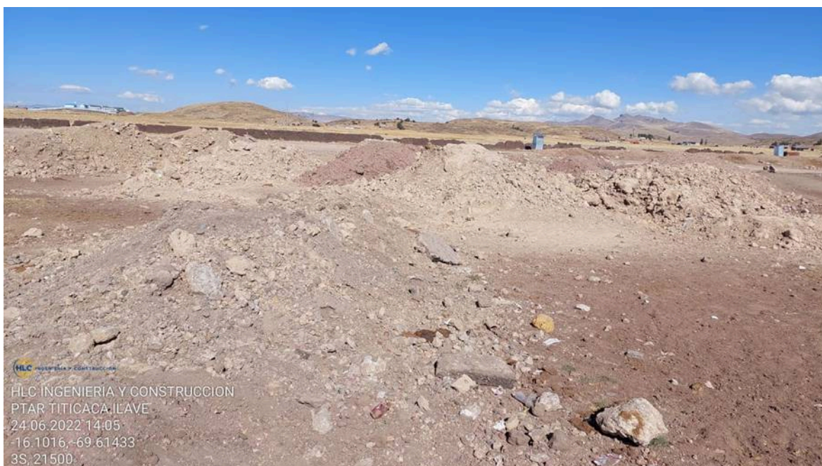
Figura 89: Disposición final del material excedente, ocasionando pérdida de la calidad del suelo y cambios en el relieve.
