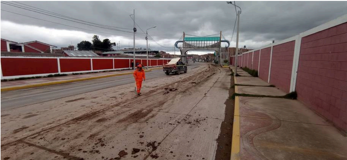
Figura 84: Debido al constante tránsito de los vehículos del proyecto, se genera barro, el cual, al secarse, se emite como material particulado por el tránsito de vehículos.
