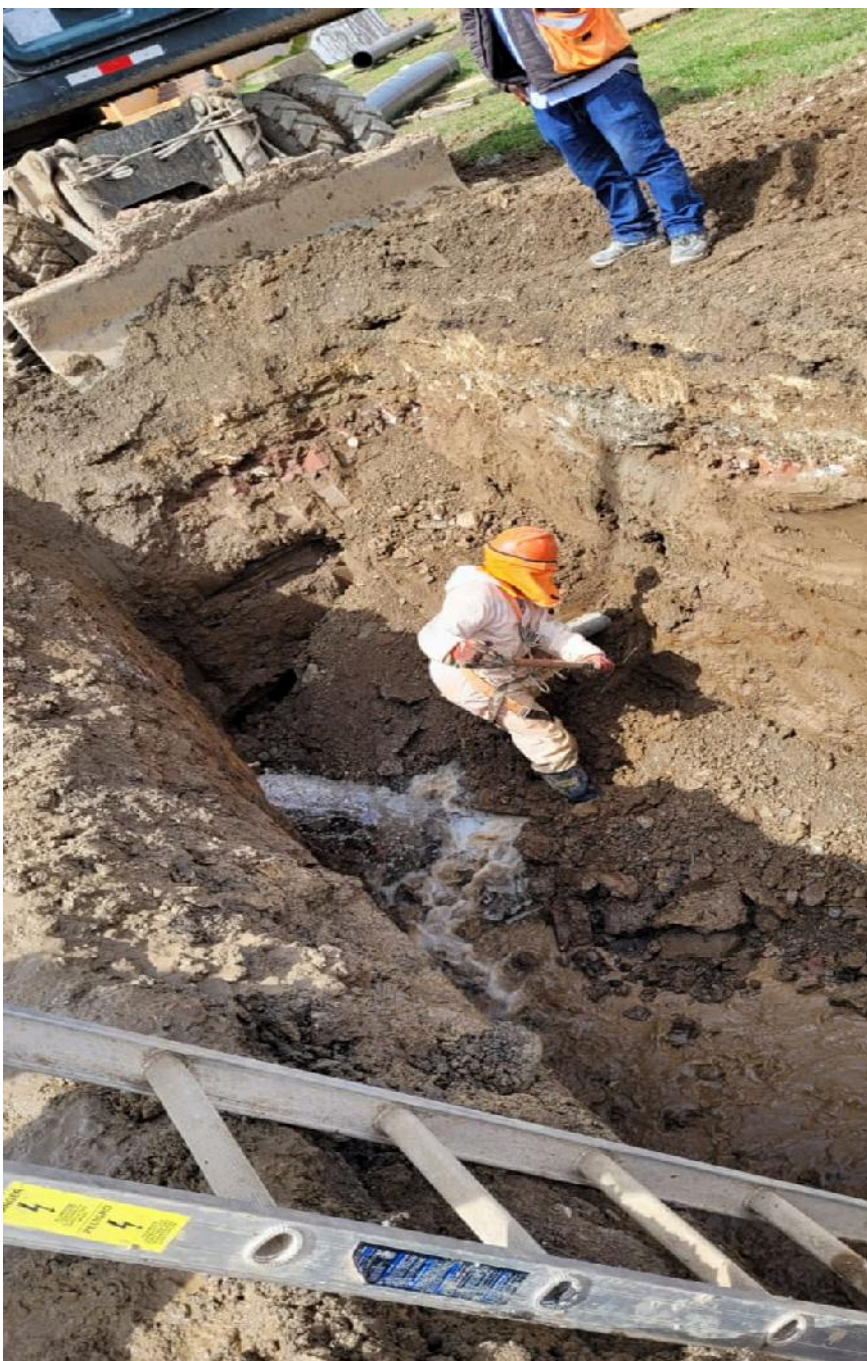
Figura 97: Ruptura de tubería matriz de agua potable, la cual posteriormente es evacuada mediante bombeo, ocasionando interrupción en el servicio de agua potable.
