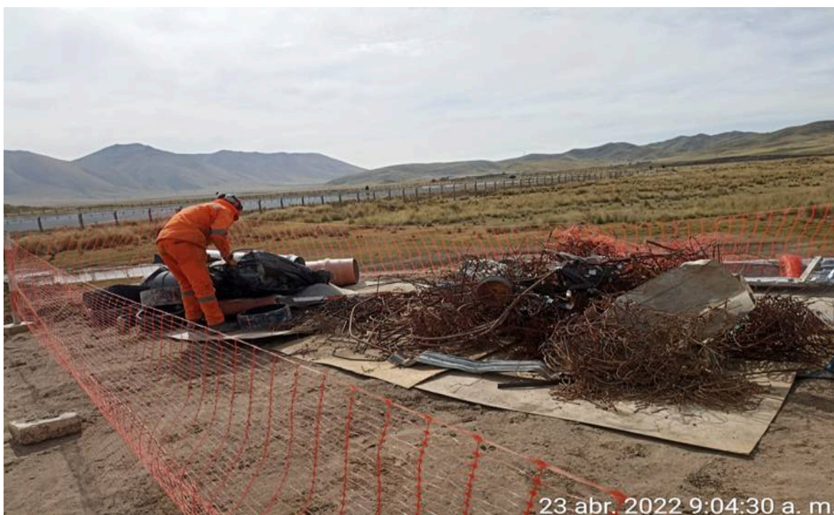
Figura 91: Residuos de la construcción que pueden impactar en la calidad del suelo.
