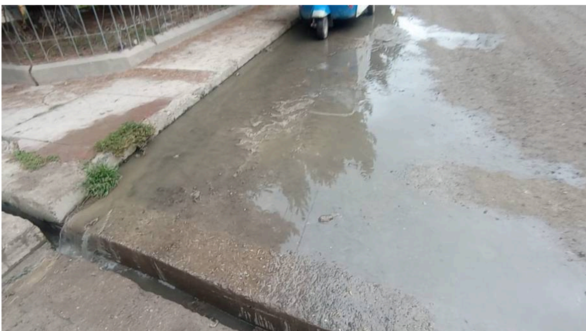
Figura 111: Esguerrimiento de aguas servidas a canaletas pluviales que desembocan en el río llave sin tratamiento alguno.
