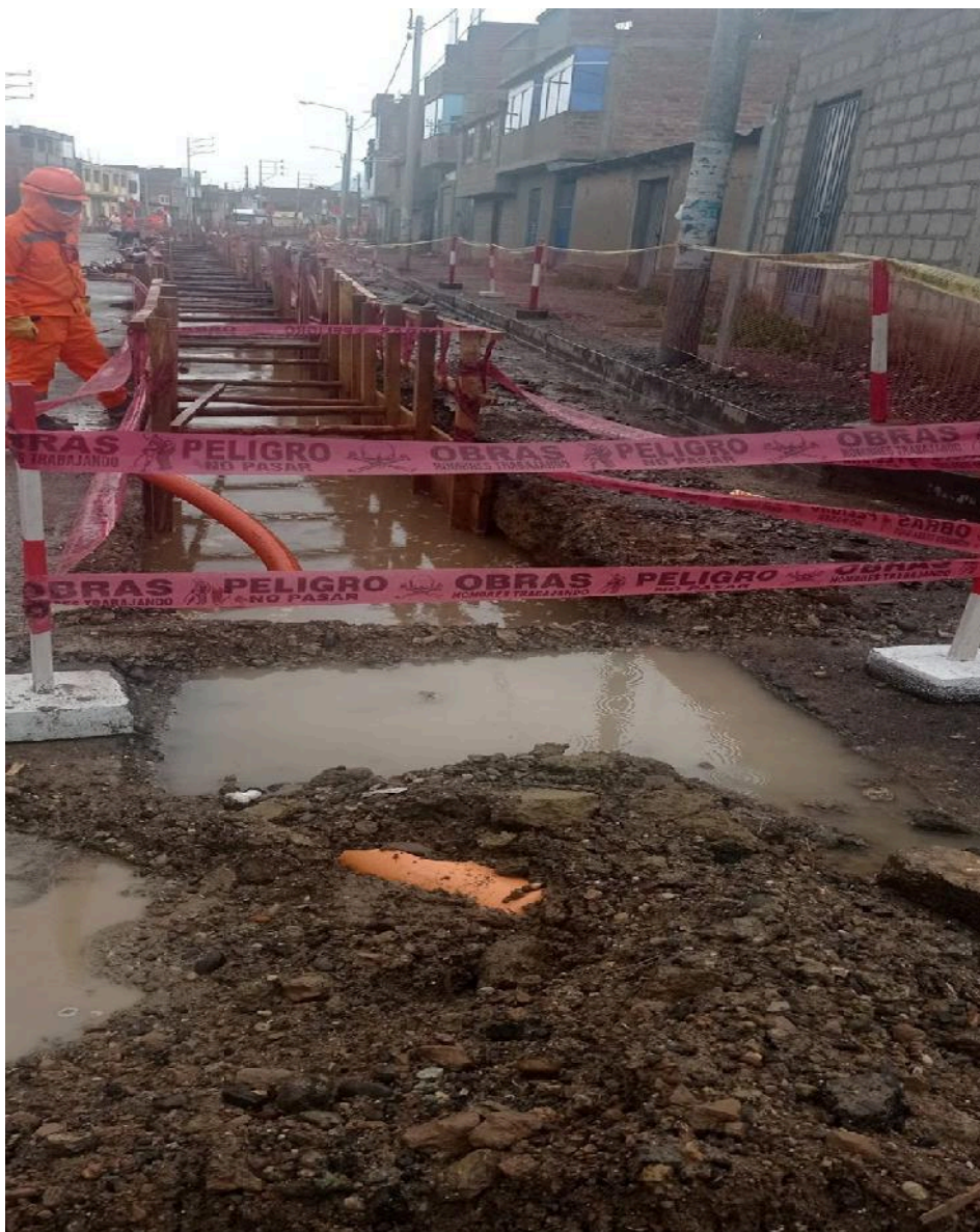
Figura 99: Colmatación de excavación debido a la ruptura de tubería matriz de desagüe; el agua residual se bombea hacia los buzones en funcionamiento.
