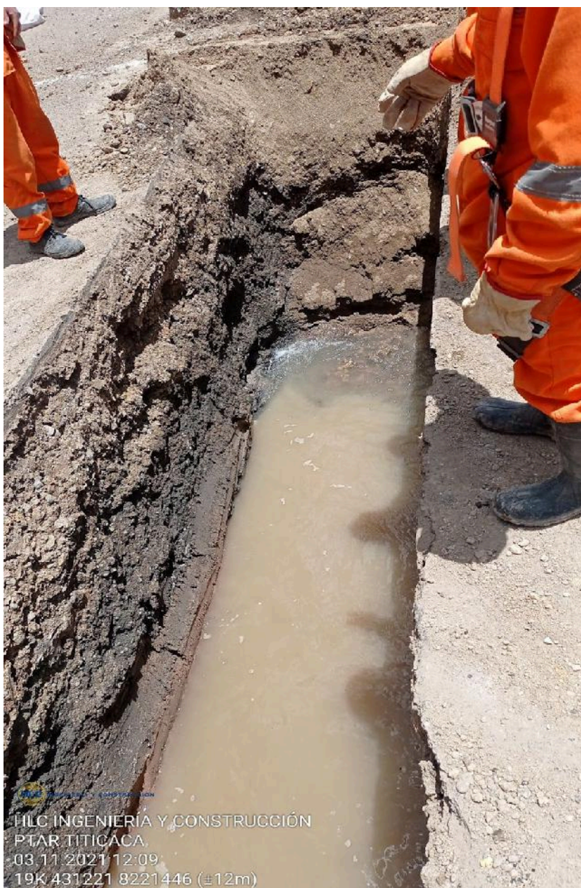
Figura 98: Excavación en terreno saturado, el cual tiene que ser evacuado mediante bombeo hacia canaletas pluviales cercanas, las cuales derivan directamente al cauce del río llave, lo que ocasiona un cambio en la calidad de agua del mismo.
