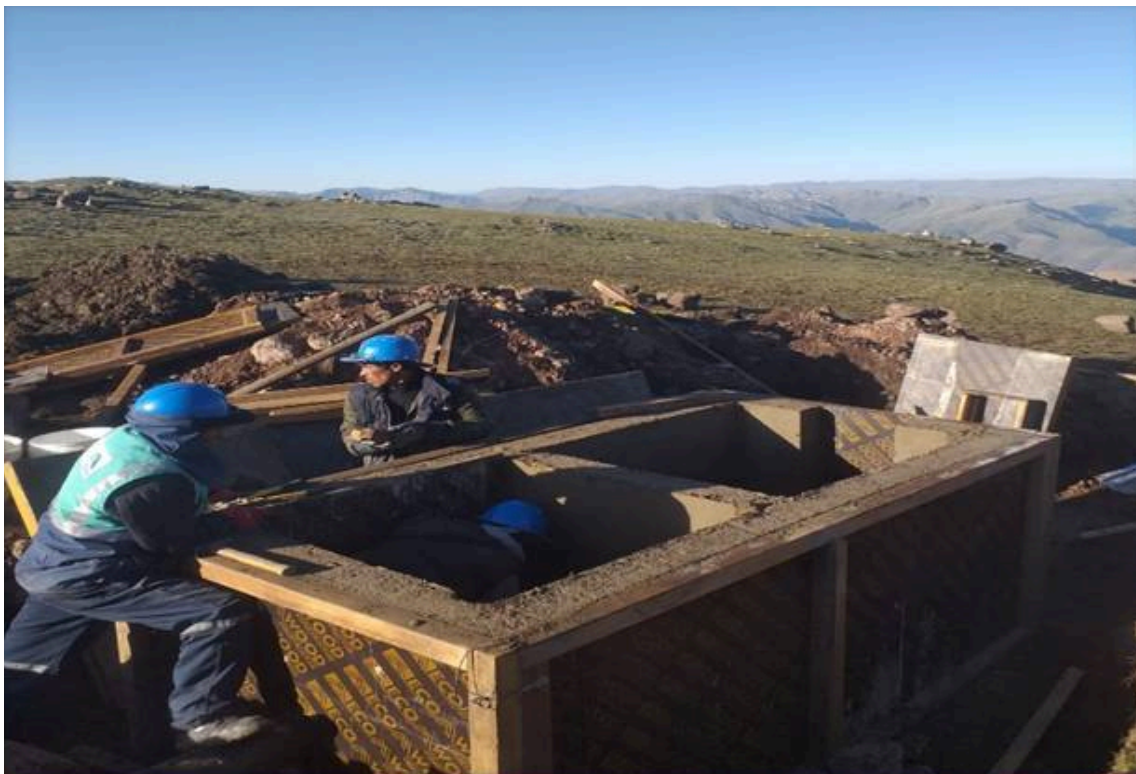
Vista N° 10: .Generación de derrames menores de concreto por el vaciado de caja de válvula.
