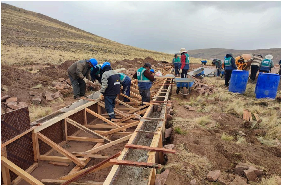
Vista N° 12: .Generación de derrames menores de concreto por el vaciado de aliviadero de demasías.
