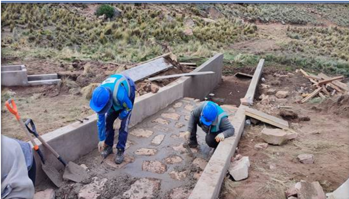
Vista N° 08: Afectación a la calidad de suelos por trabajos de mezclado de concreto.
