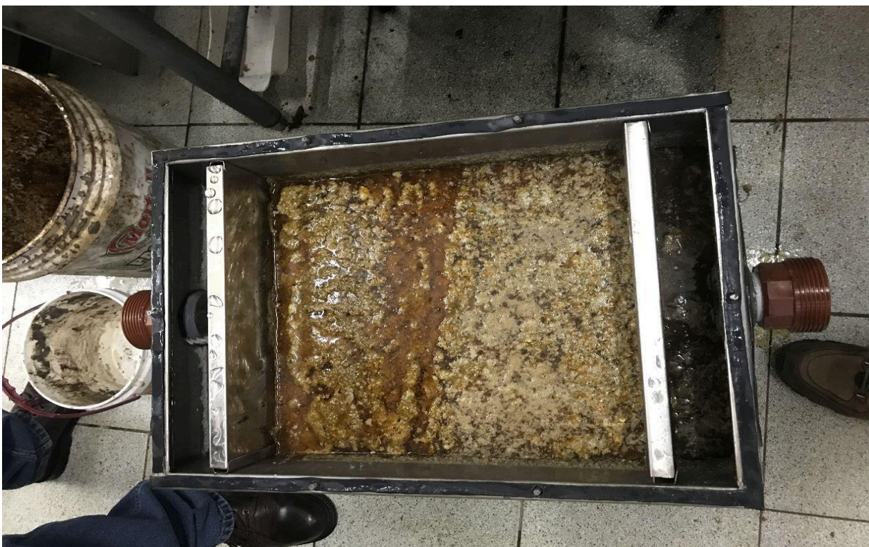
Fotografía 03. Saturación de trampa de grasa comercial, con generación de olores, en ambiente de cocina.
