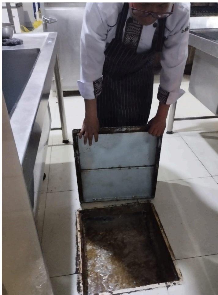
Fotografía 05. Trampa de grasa empotrada saturada.
