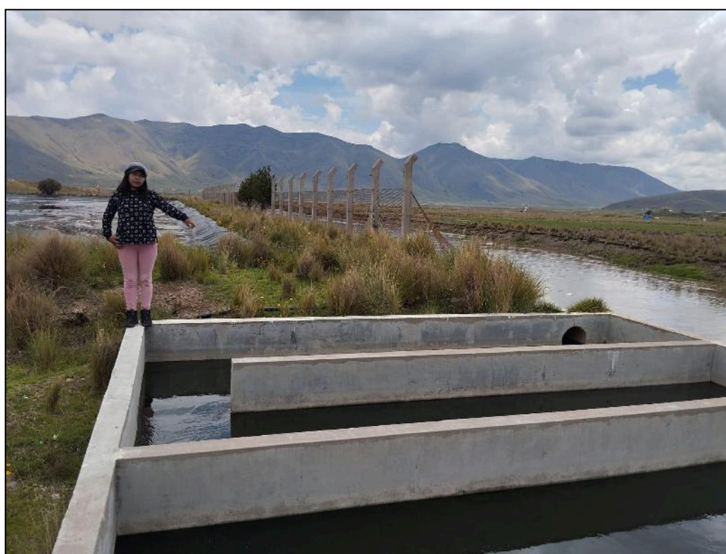
Figura 31: Planta de Tratamiento de Aguas Residuales de Ayaviri.
