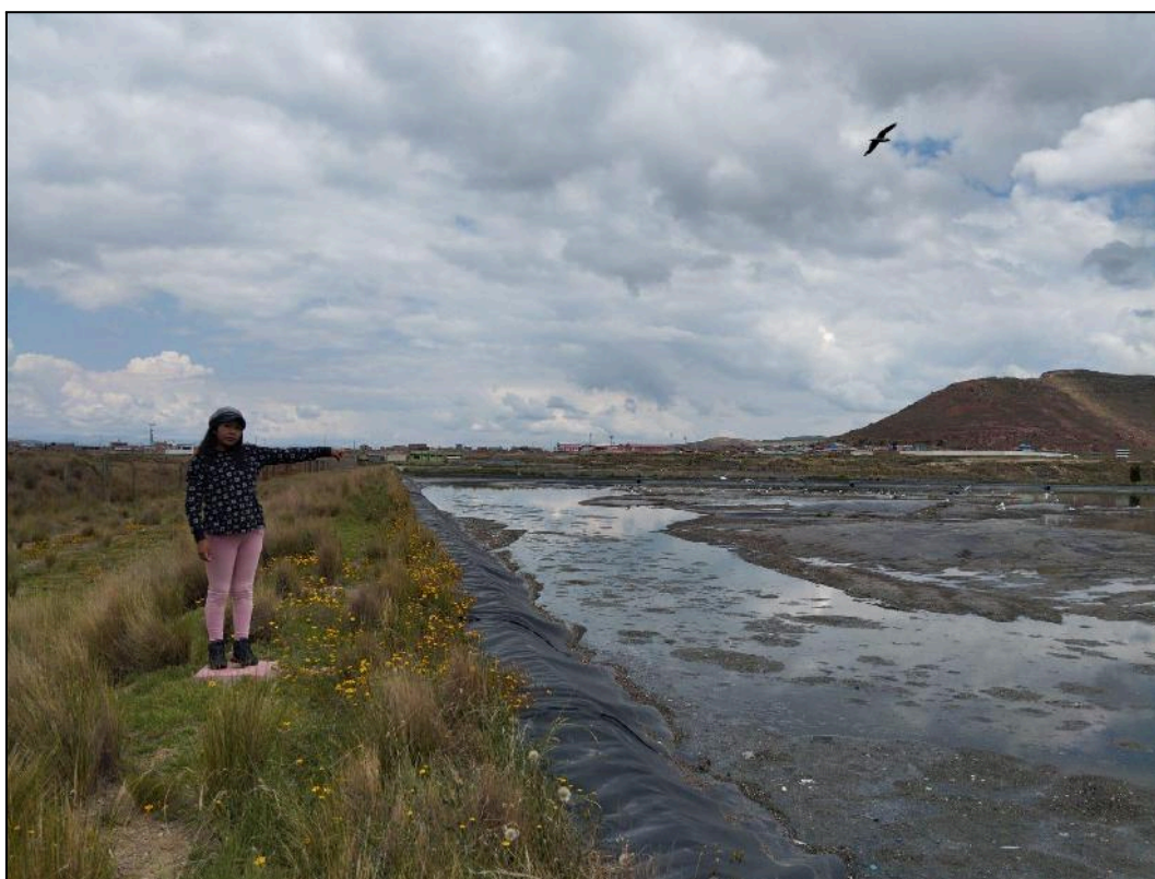
Figura 32: Condiciones que se encuentra la Planta de Tratamiento de Aguas Residuales de Ayaviri.
