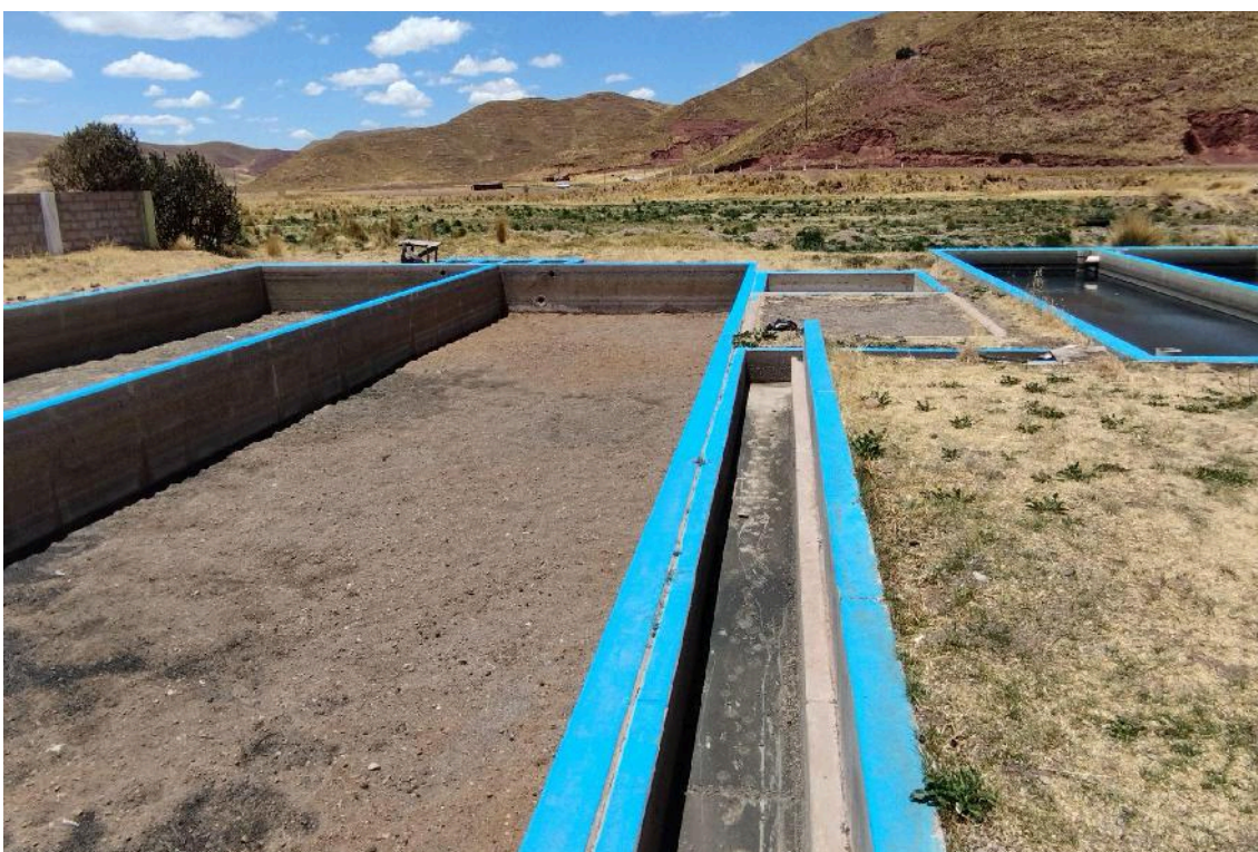
Figura 21. Filtros lentos de arena sin funcionamiento
