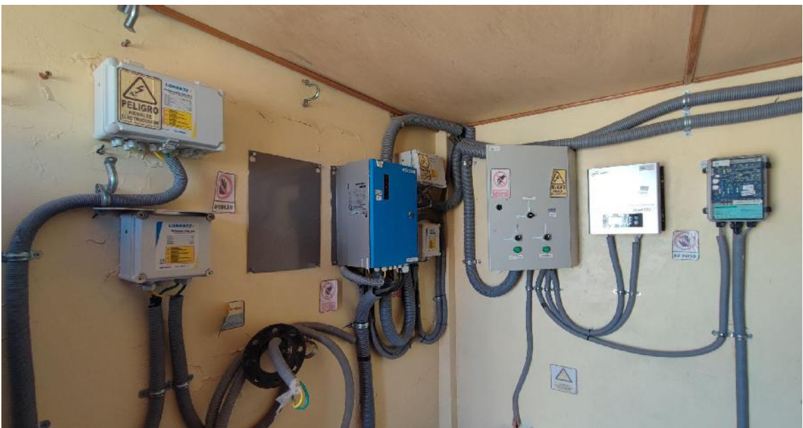
Figura 16: Riesgo eléctrico en la instalación de la captación autónoma de energía renovable - Churupampa, UGASS - Ilave.
