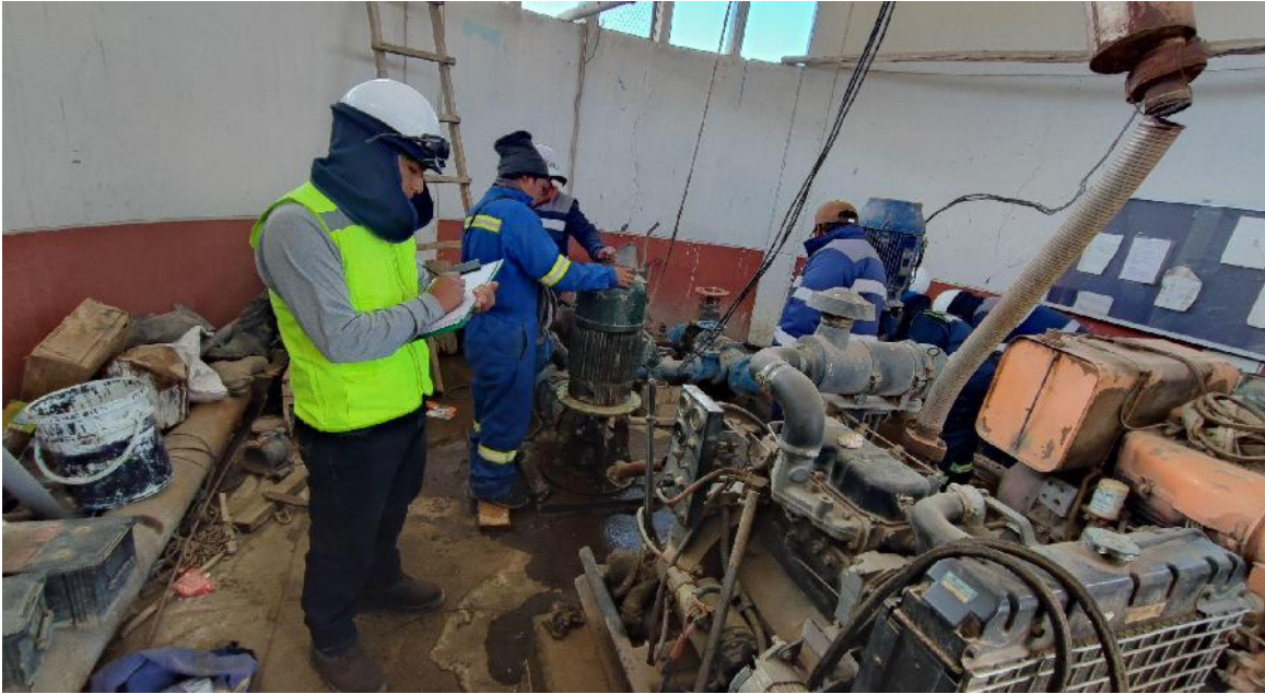
Figura 19: Registro del uso de EPPs no apropiados en las instalaciones de la captación Copani, UGASS - Ilave.
