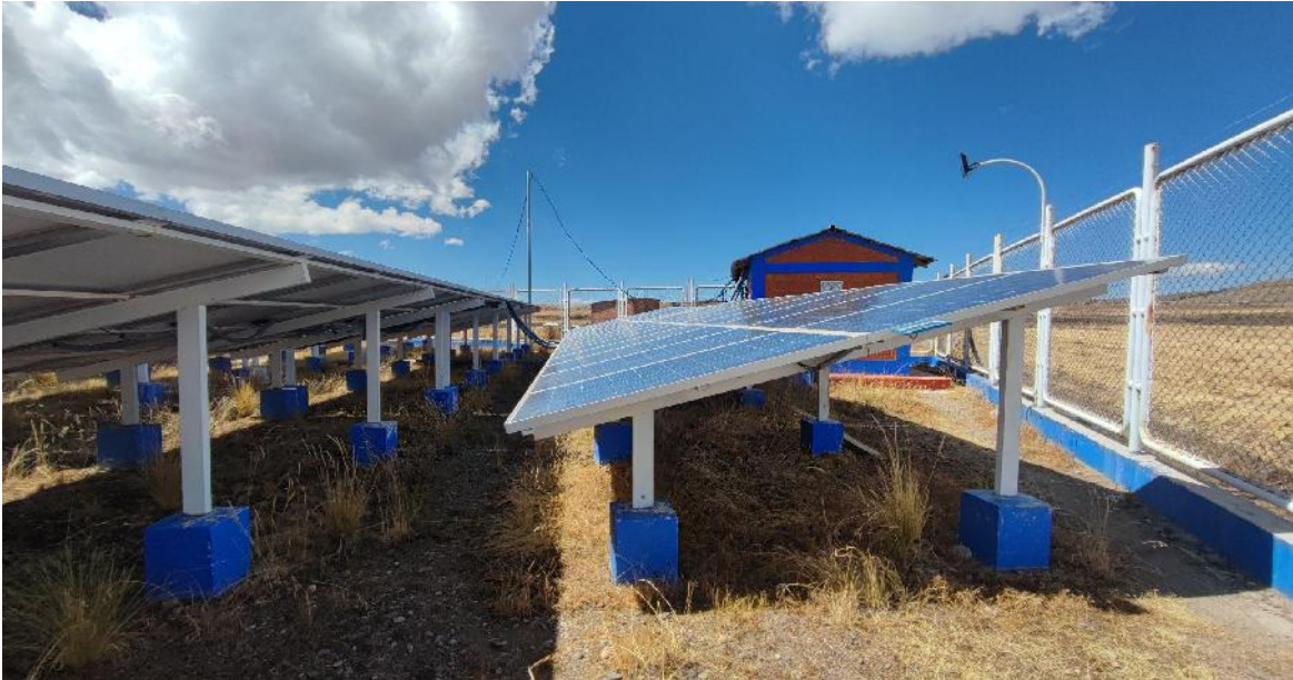
Figura 15: Estación de captación autónoma de energía renovable - Churupampa, UGASS - Ilave.
